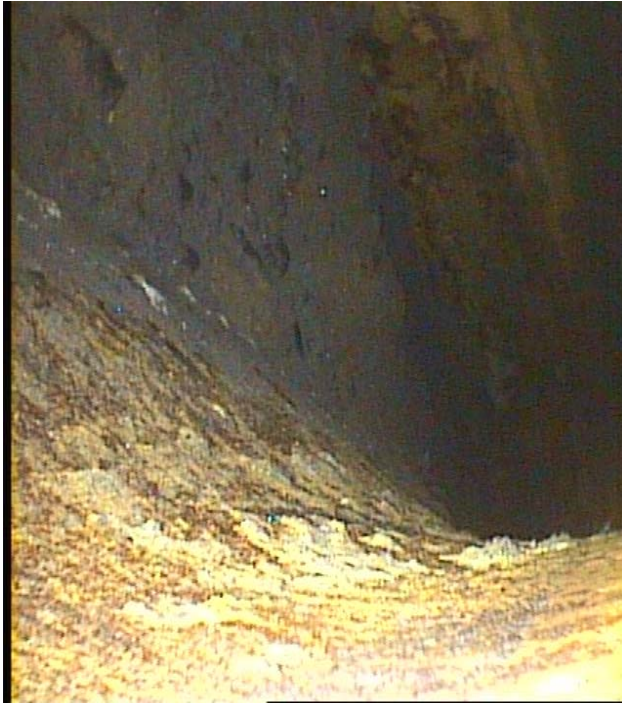
Рис.6 Дно «кармана» после отмывки. Отсутствие шлама.
