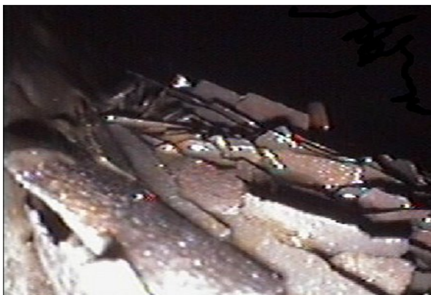
Рис.5 Залежи шлама в «кармане» коллектора парогенератора
